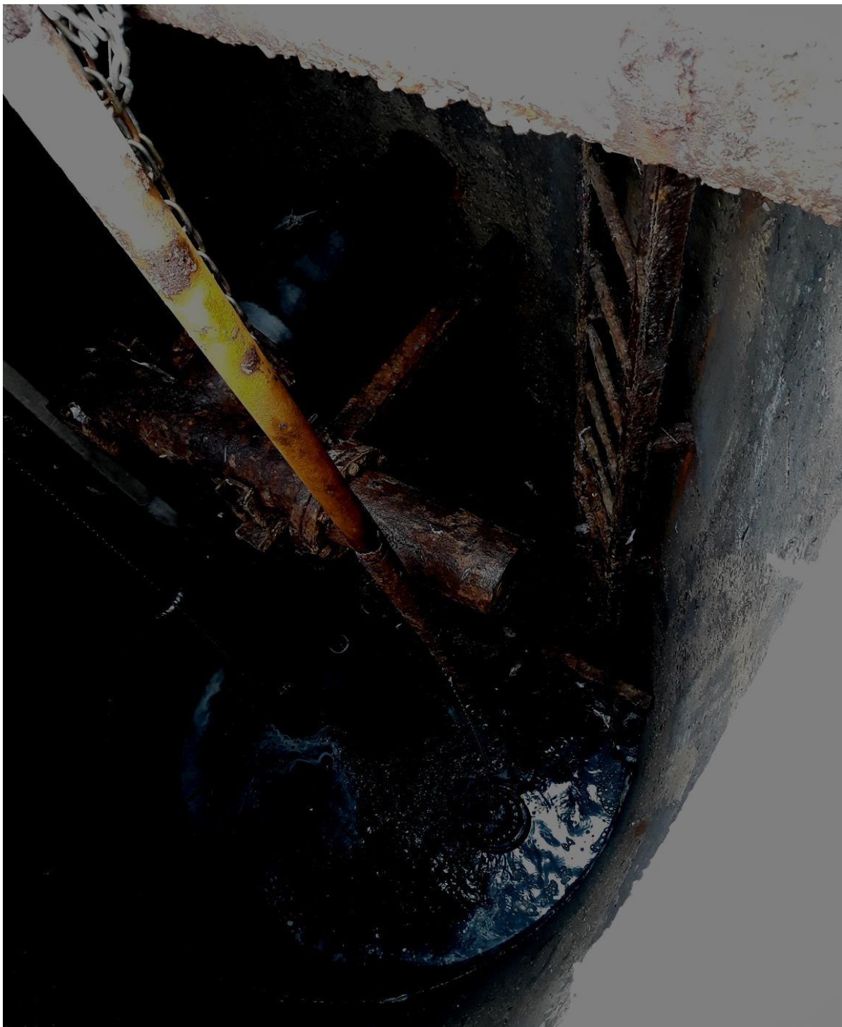
Rysunek nr 1. Wnętrze komory roboczej przepompowni P1.
